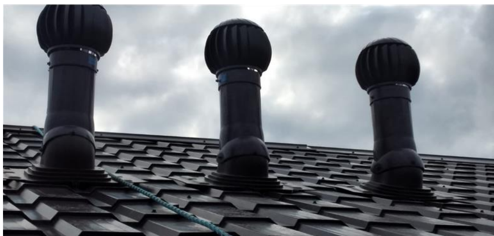
Рис. 4. Размещение РВТ на кровле здания
