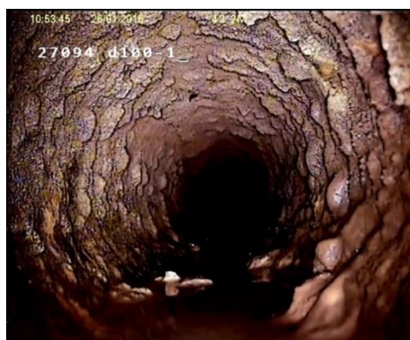
Рис. 4. Фрагмент отложений на внутренней поверхности канализационного выпуска в водоем
