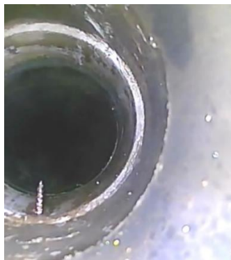
Рис. 6. Саморез внутри трубопровода
