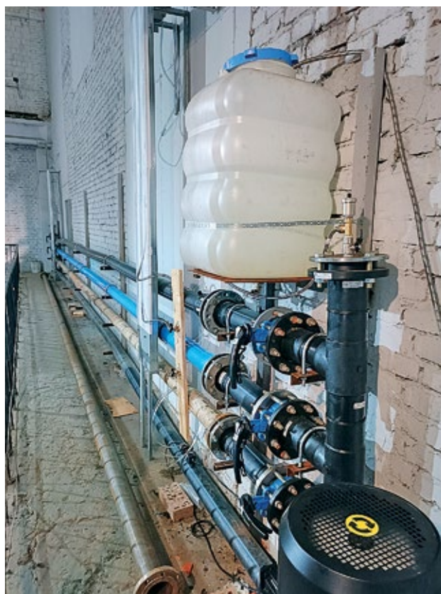
Рис. 1. Общий вид испытательного стенда
